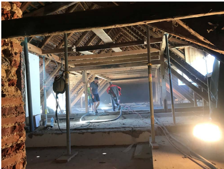
NACH DEM SANDSTRAHLEN DER TRÄGER
