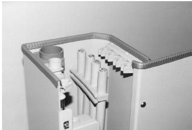
Abb. 38, 39: Abfallvermeidung durch Steigleitungen im Kabel- führungs- schrank
